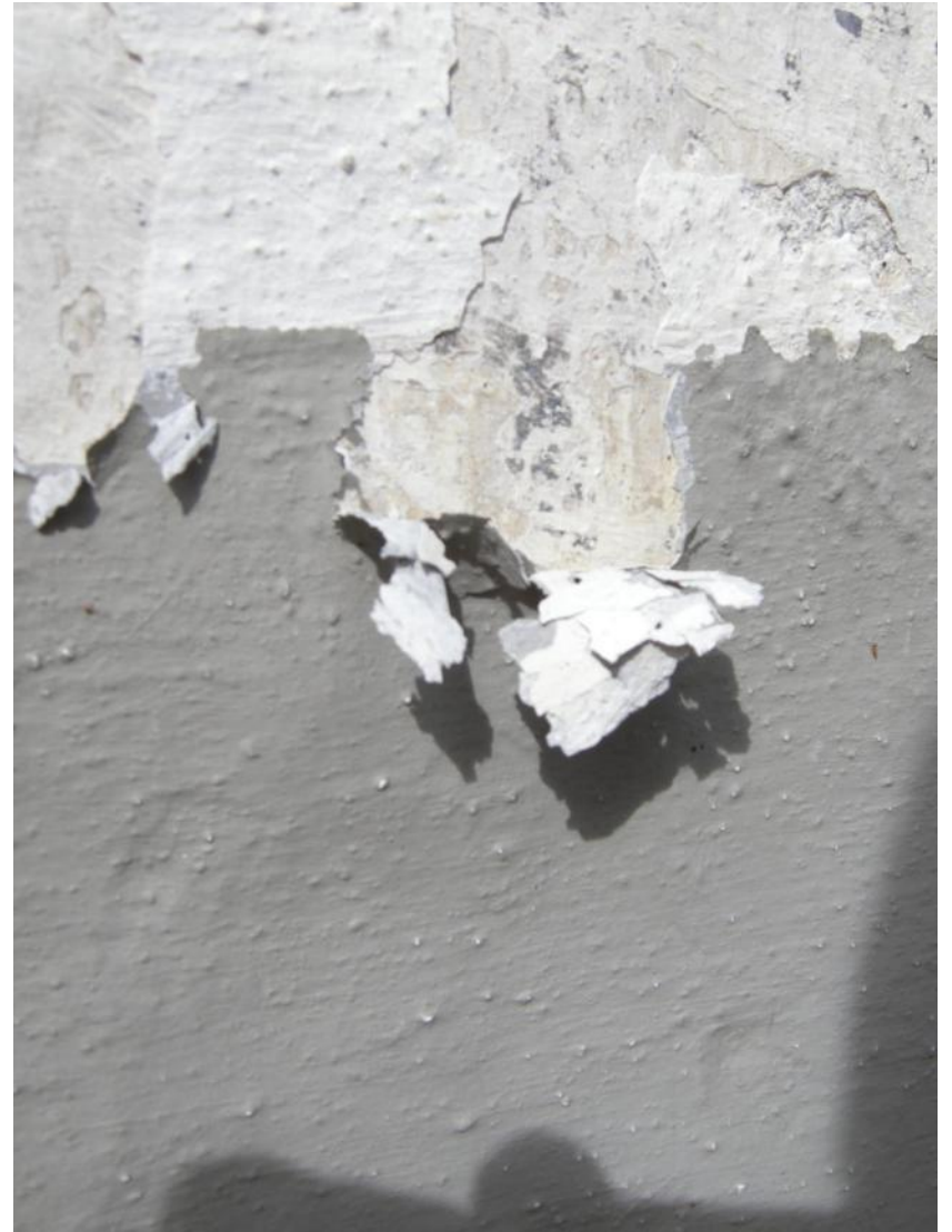
Putze und Anstriche mit schalenartiger Ablösung
